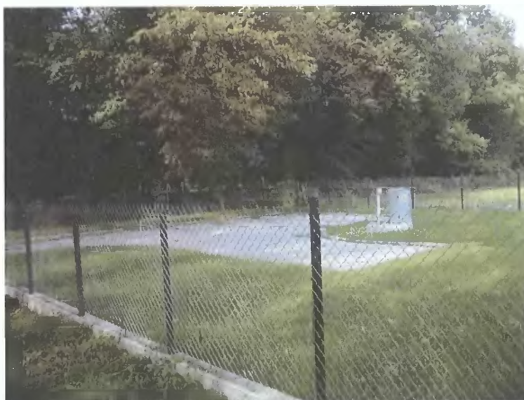
Przepompownia w Ołtarzewie
